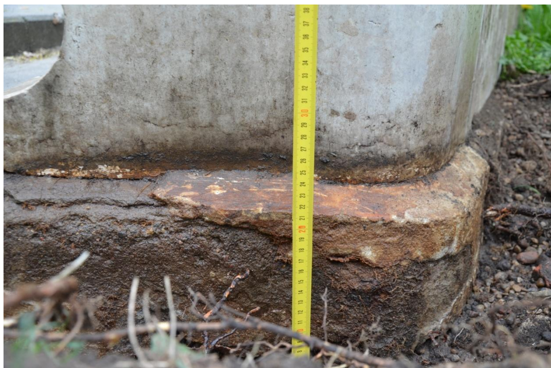
Fot.12. Ławka Schillera, fragment stopy siedziska po usunięciu ziemi - widoczny przebarwiony element profilowania, w jego obrębie rozległe, częściowo uzupełnione ubytki powierzchni oraz rudawe, brązowe przebarwienie surowca.
