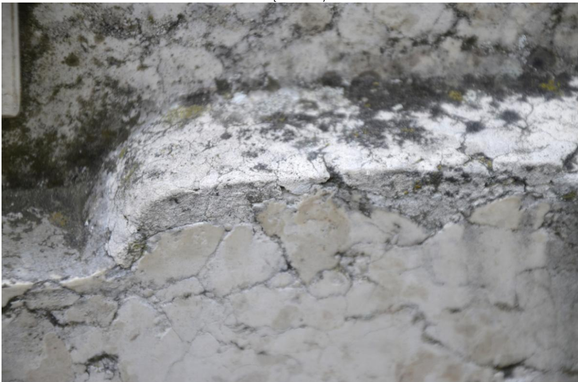
Fot.9. Ławka Schillera, część wierzchnia siedziska, widoczne uzupełnienie ubytku formy wprowadzone w czasie ostatniej renowacji.
