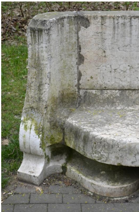
Fot. 5. Ławka Schillera, stan zachowania. Na krawędzi bloków tworzących siedzisko widoczne pociemniałe uzupełnienia ubytków.
