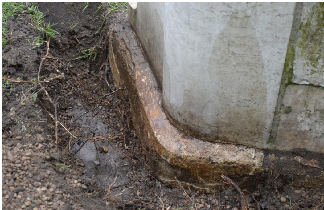
Fot. 11. Ławka Schillera, fragment stopy siedziska po usunięciu ziemi - widoczny przebarwiony element profilowania, w jego obrębie liczne ubytki. W dnie odkrywki ziemnej widoczny beton na którym posadowiona jest ławka.
