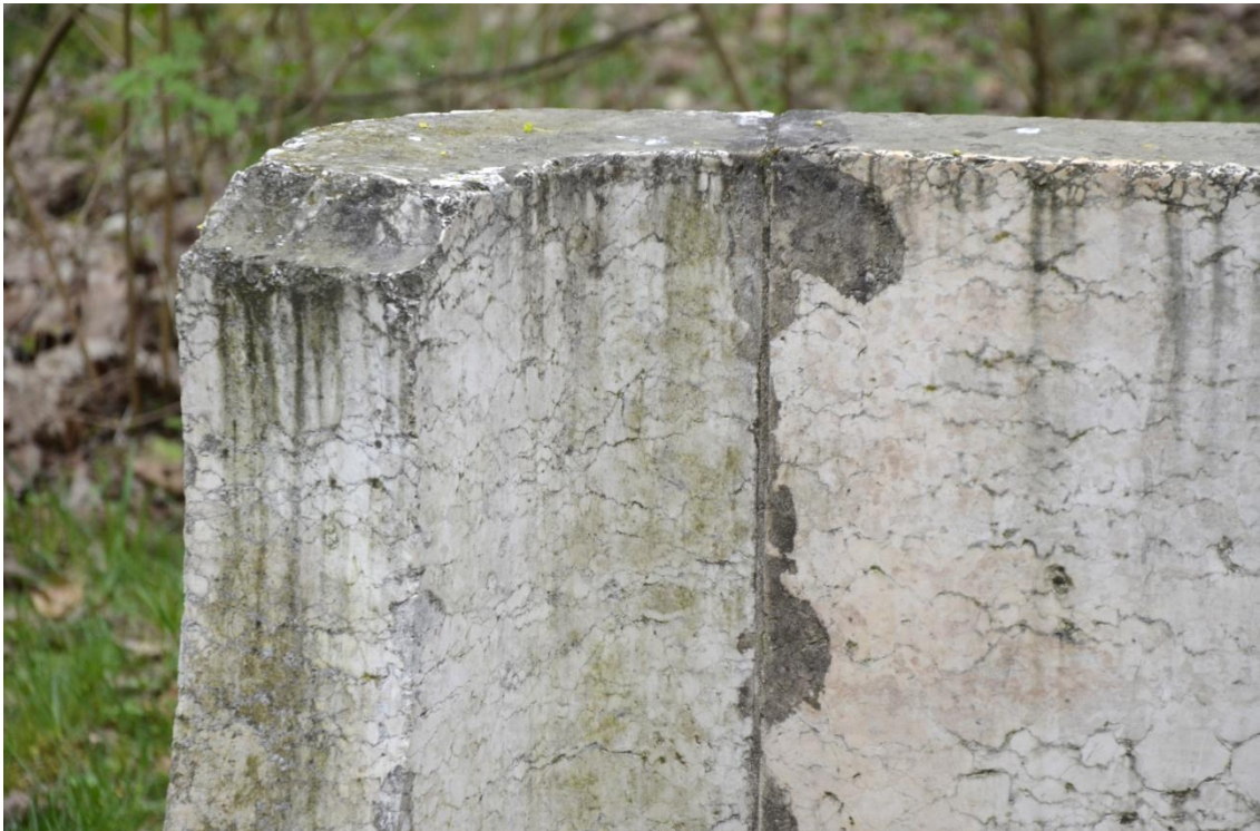
Fot. 8. Ławka Schillera, wierzchnia płaszczyzna siedziska, poza nawarstwieniami widoczne liczne ubytki na krawędzi formy.
