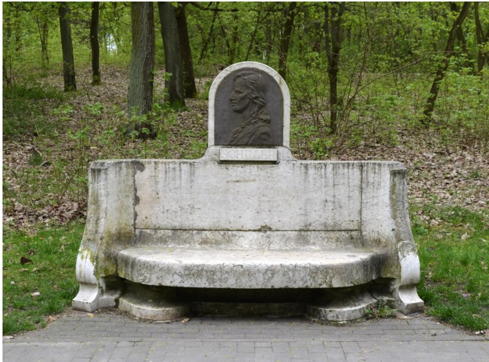
Fot.1. Ławka Schillera, ogólny stan zachowania. Widoczne zanieczyszczenie powierzchni przybierające formę zacieków oraz nawarstwień nagromadzonych w zagłębieniach formy.
