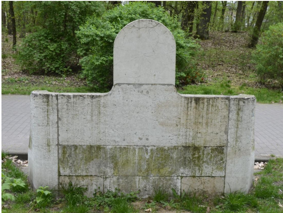
Fot.4. Ławka Schillera, część tylna (południowa) ogólny stan zachowania. Widoczne zanieczyszczenie powierzchni przybierające formę zacieków oraz zielonkawe nawarstwienia mikrobiologiczne w części przyziemnej.
