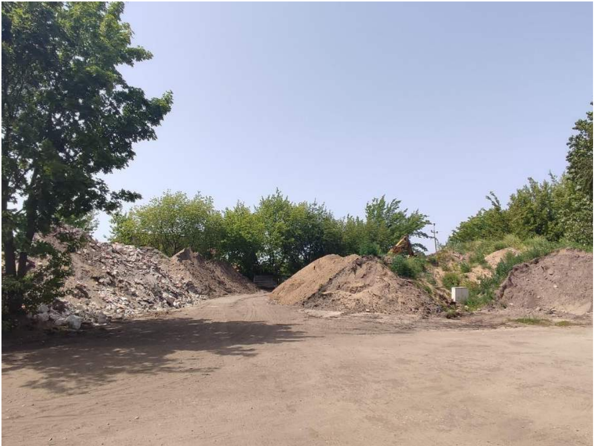
Fotografia 5. Odpady budowlane (gruz) oraz pozostałe materiały składowe w zachodniej części obszaru
