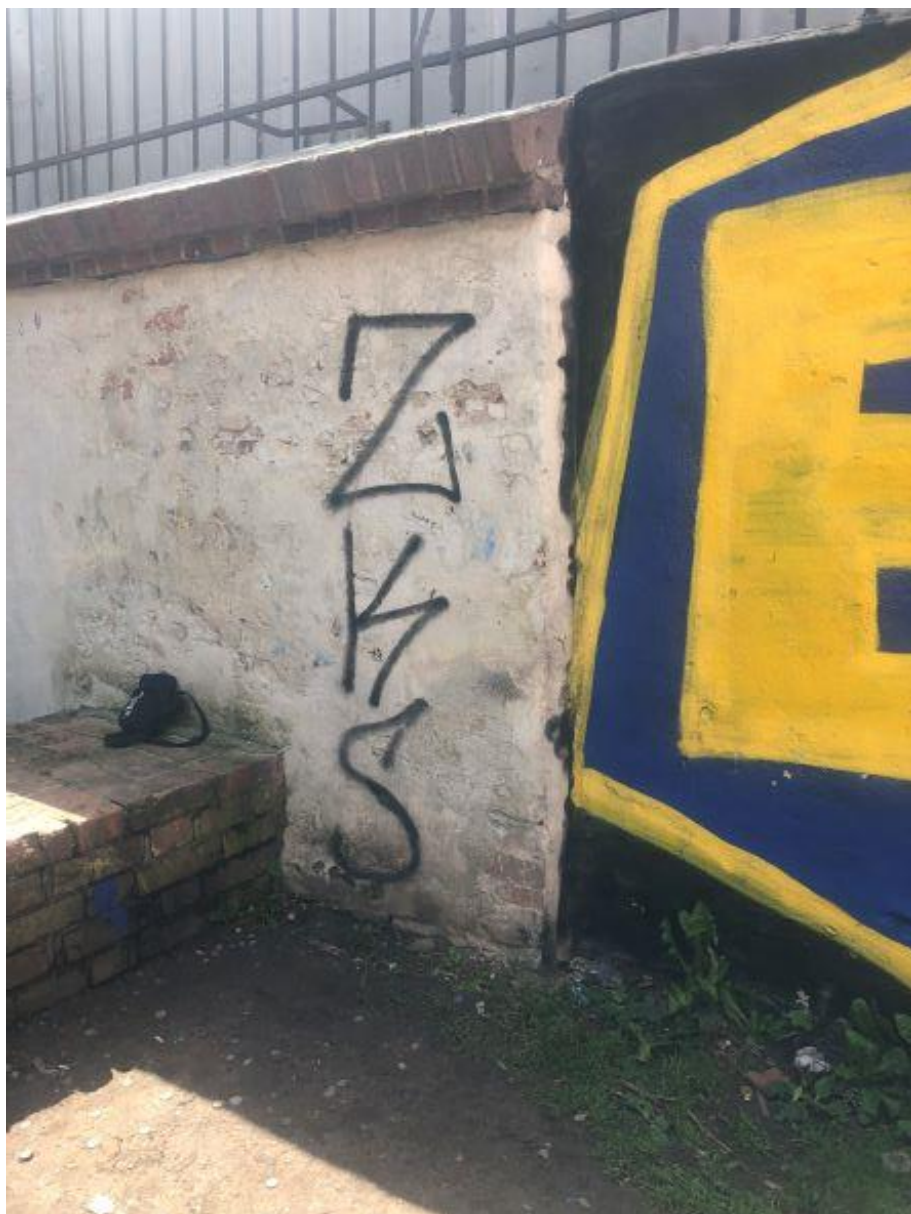
3. Fragment muru obok budynku przy ul. Wały gen. Sikorskiego 12, strona zachodnia.
