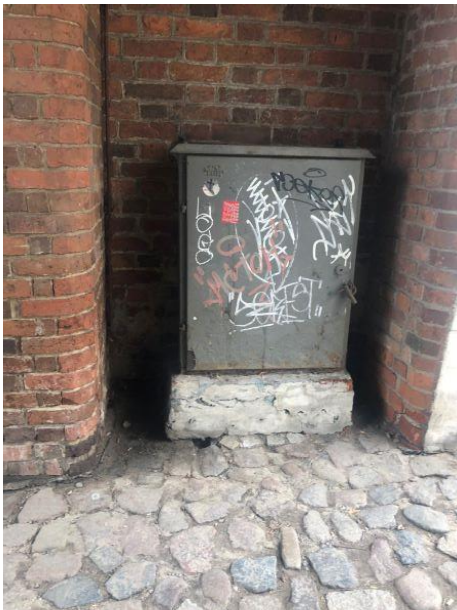
35. Szafka teletechniczna, przejazd Bramy Mostowej, strona zachodnia.
